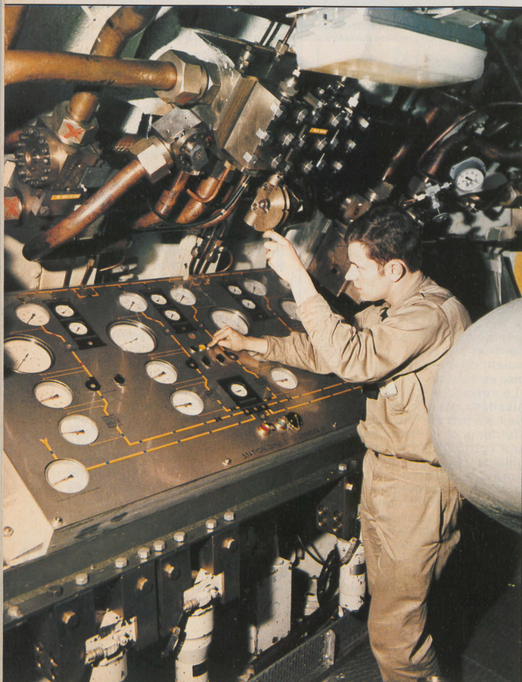
Le confinement du sous-marin nécessita de nombreuses études pour y installer tous les matériels concourant à la propulsion : cœur nucléaire, turbines à vapeur, auxiliaires. Ici, la station d'huile principale (photo ECPA)
